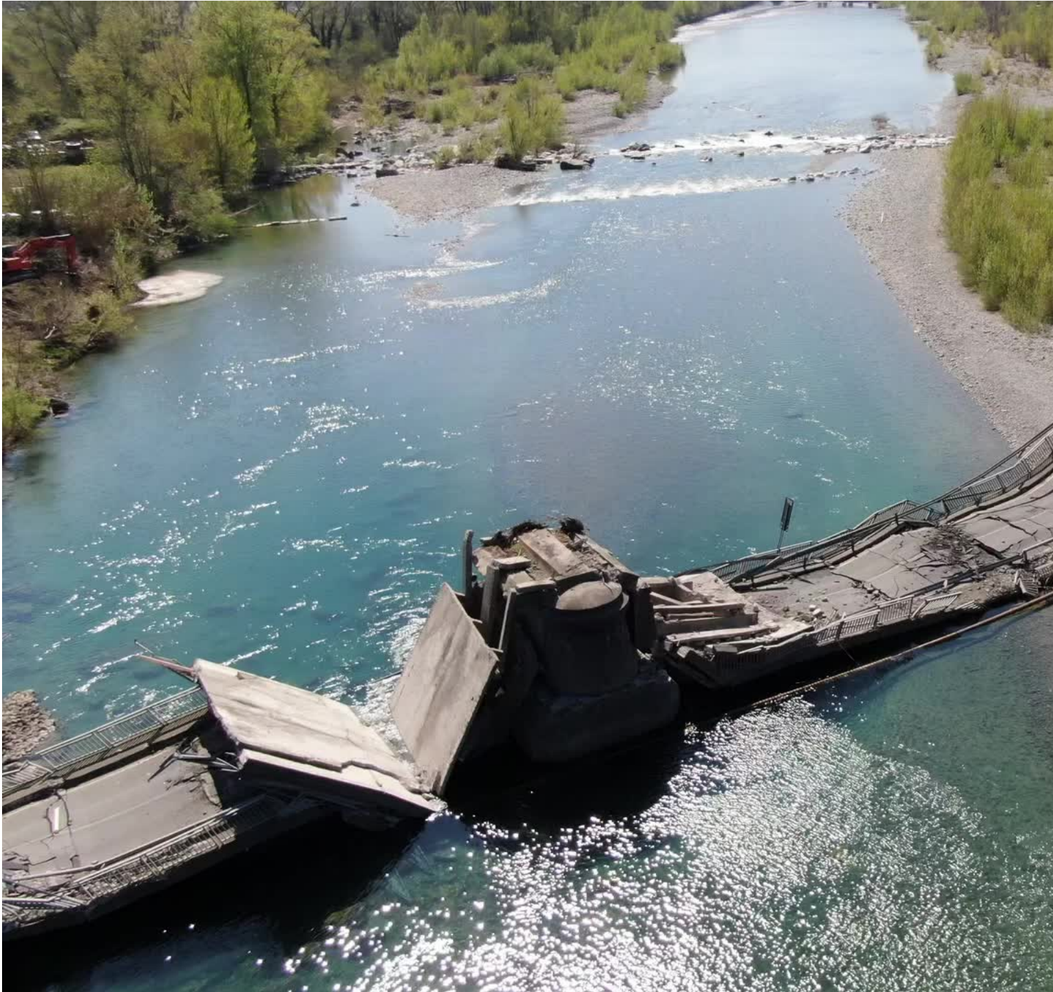
Cronaca video - Le immagini dal drone del ponte crollato al confine tra Liguria e Toscana. La struttura è collassata interamente sul fiume Magra.
